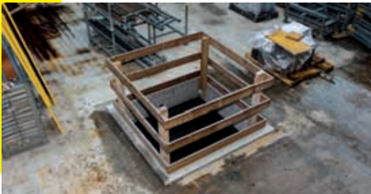
9 Une barrière autour des ouvertures de sol.
