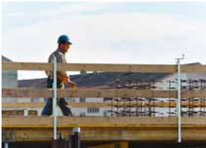
Absturzkante an Deckenschalung (z.B. bei Betonierunterbrüchen)
