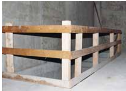
Absturzkante im Rohbau innen (z.B. Treppenöffnung)
