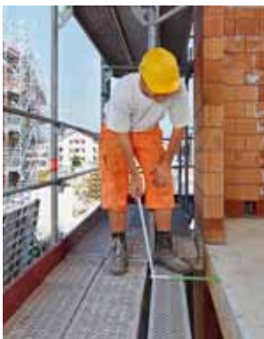
Regel 5 Täglich Gerüstkontrollen.
