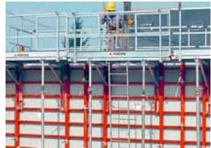
Absturzkante an Betoniergerüst
