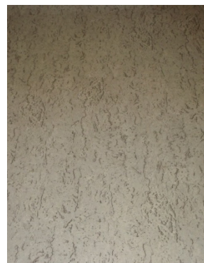
2 Auch bei diesem elastischen Bodenbelag (Bahnware) ist der Asbest im Kunststoff festgebunden.
